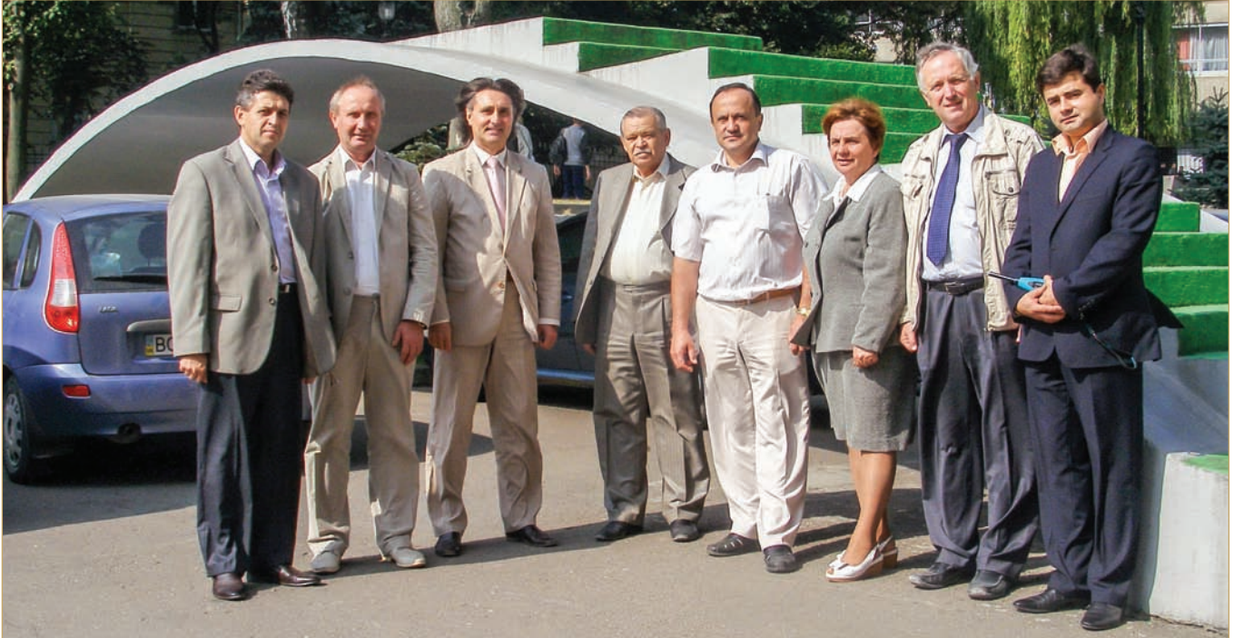
Огляд технічного стану містка Тульє, збудованого у 1894 р. Зліва направо: заст. декана БВО, доц. каф. ГС О. В. Вербовський, декан БВО, зав. каф. БКМ, доц. П. Ф. Холод, зав. каф. АДМ, проф. С. Й. Солодкий, проф. каф. АДМ В. Г. Кваша, дир. ІБІД, проф. З. Я. Бліхарський, декан ПВО, проф. Х. С. Соболев, зав. каф. БВ, проф. М. А. Саницький, заст. дир. з вих. роб., ст. викл. каф. АДМ Ю. Л. Новицький
