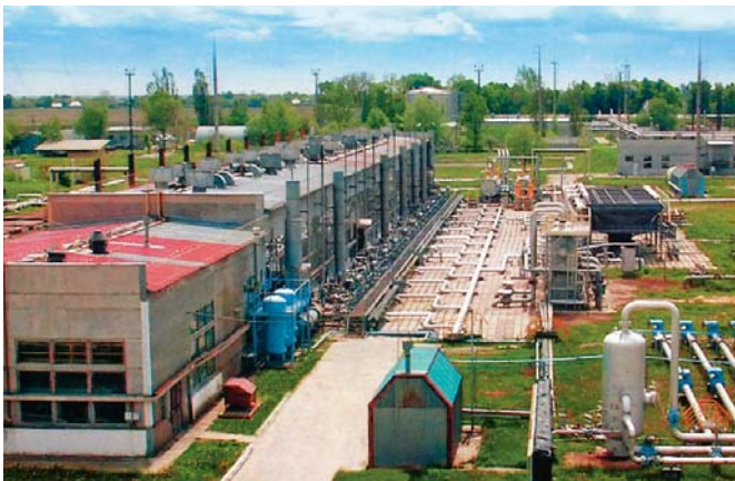
Компресорна станція сайклінг-процесу на Тимофіївському ГКР
