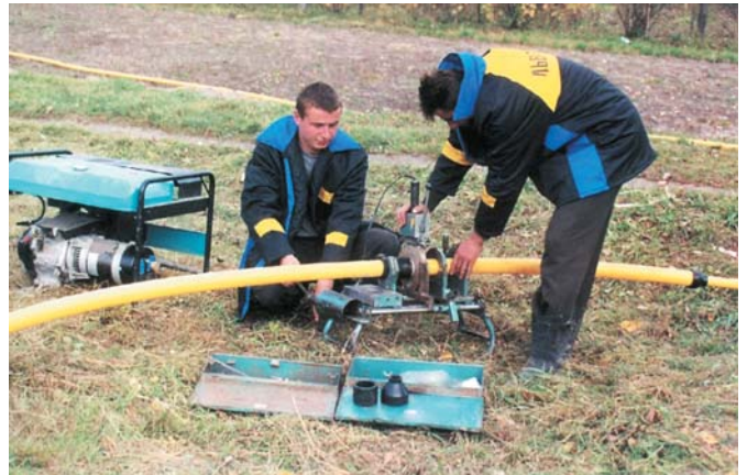
Розподільні газопроводи із пластмасових труб
