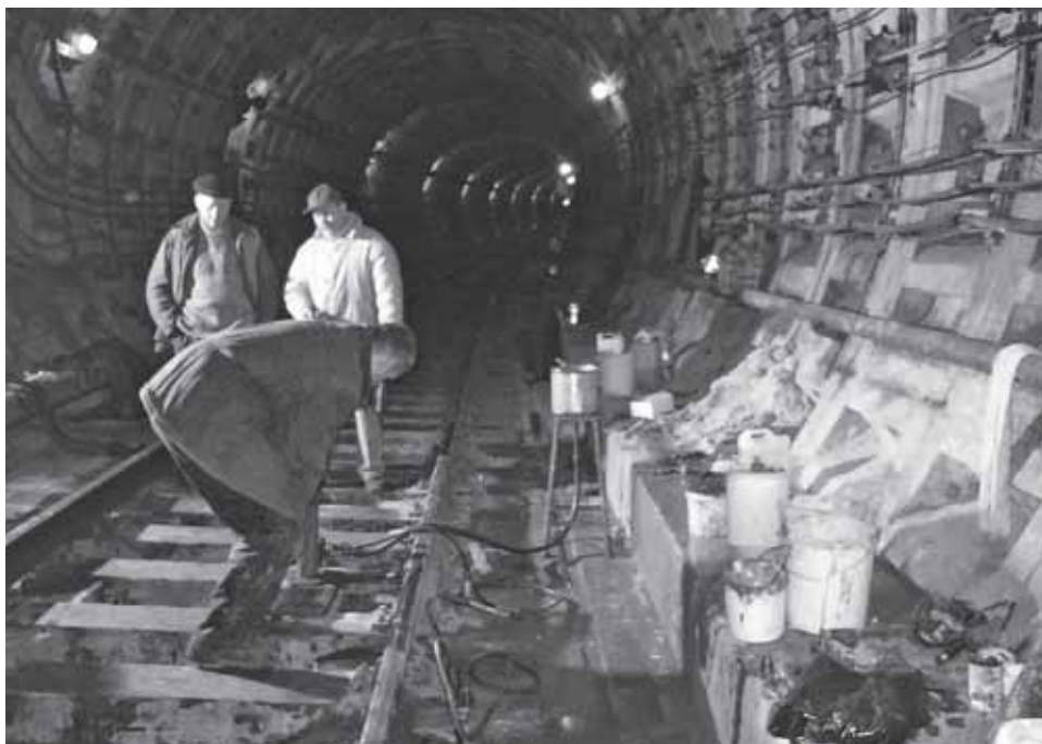
Ліквідація прориву води з-під колії поблизу станції метрополітену «Академістечко» шляхом ін'єктування швидкотвердіючої при контакті з водою поліуретанової композиції серії «Моноліт.З. ПУ»
